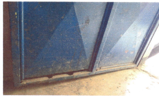
Foto 4: Puerta de la cocina en mal estado.
